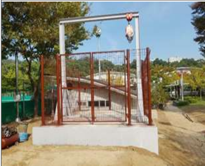
집수정 및 펌프시설 설치 현황
